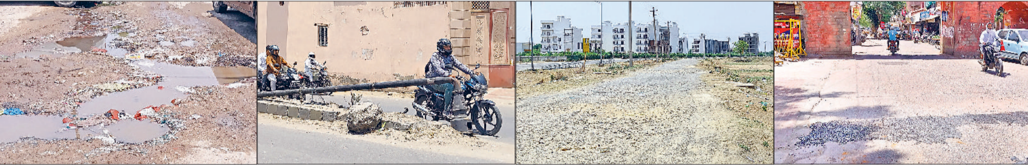
रेवाड़ी। ब्रास मार्केट की मुख्य सड़क पर गड्ढा, सरकुलर रोड पर ब्रह्ममगढ़ के पाल डिवाइडर पर टूटा पड़ा पोल, सेक्टर-18 की खस्ताहाल सड़क, बाजार में सड़क बनाने की बजाय ऐसे किए गए पैचवर्क।
