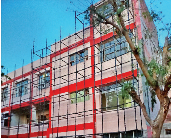
रेवाड़ी। मॉडल टाउन थाने की बिल्डिंग का चल रहा कार्य तथा मॉडल टाउन थाने की जर्जर बिल्डिंग का फाईल फोटो।
