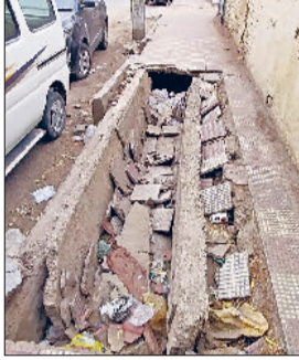
रेवाड़ी। सरकुलर रोड से गुजर रहे बरसाती नाले का हाल, राव तुलाराम पार्क के पास गंदगी से भरा नाला, मॉडल टाउन में हिंदू स्कूल के पास की गई नाले की सफाई, मॉडल टाउन में नाले से निकाली गई गंदगी।
