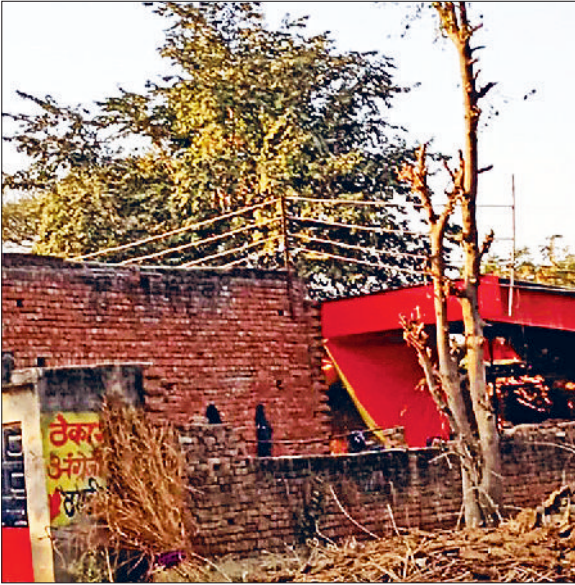
रेवाड़ी। नाहड़ में दुकान के ऊपर से गुजर रही बिजली लाइन व नाहड़ में मकान के ऊपर से गुजर रही बिजली लाइन।
