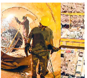
बचाव अभियान में बड़े पैमाने पर जुटे कर्मचारी : बचाव अभियान में 18 संगठन, 54 अधिकारी और 703 कर्मि लगे हुए हैं। 22 फरवरी से श्रीशैलम लेफ्ट बैंक केनाल सुरंग की छत ढह जाने से उरुमें श्लोक फंस गए थे। इन्होंने 8 लोगों को सुरक्षित निकालने का अभियान चल रहा है।
