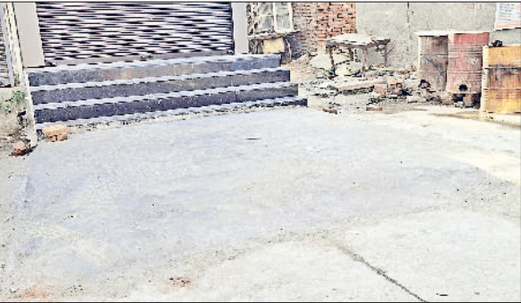
झज्जर। शहर के मेन बाजार में दुकान के बाहर बनाया हुआ अवैध चबूतरा।
