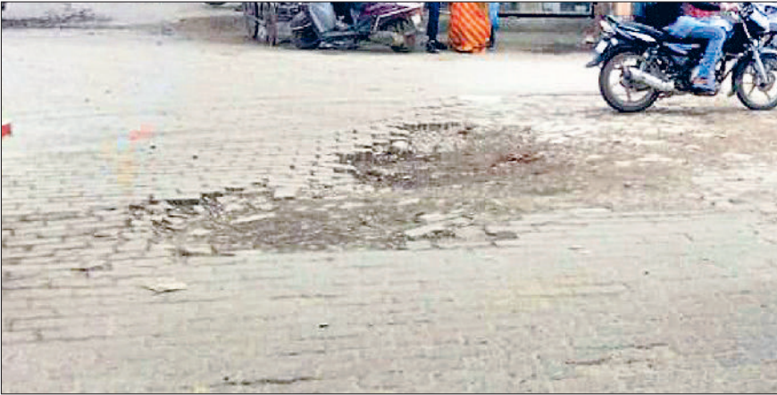
महेंद्रगढ़। जर्जर अवस्था सिनेमा रोड की सड़क।
