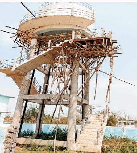
पानी टंकी का हुआ अधूरा निर्माण।
