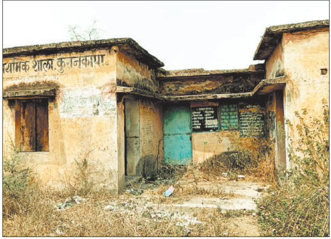
ग्राम स्थित जर्जर स्कूल भवन।
