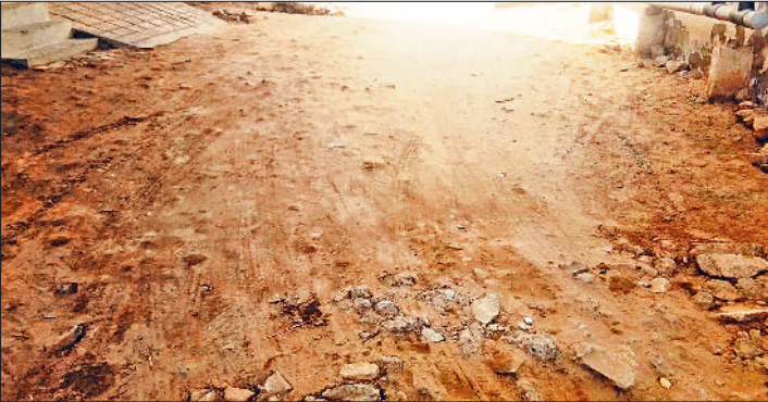
महेंद्रगढ़। जर्जर अवस्था में सड़क।
