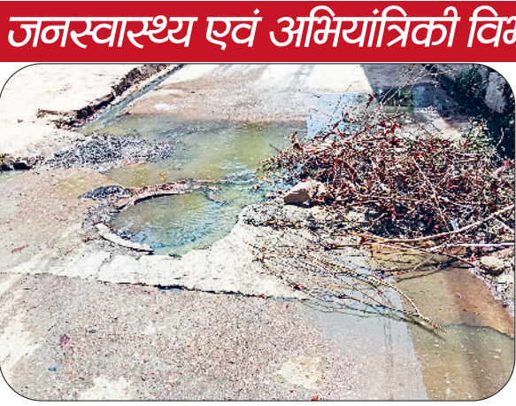
नारनौल। चांदुवाड़ा में ओवरफलो सीवर से बहती गंदगी व मिल्क चिलिंग प्लांट के सामने तोड़ी गई सड़क, जिसकी मरम्मत तक नहीं करवाई।
