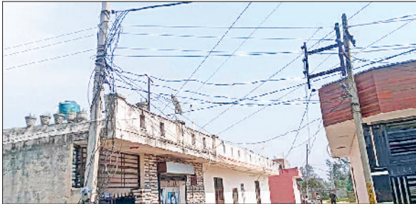
यमुनानगर। रादौर में वीआईपी कॉलोनी में घरों के ऊपर से गुजर रही हाईटेंशन तारें।
