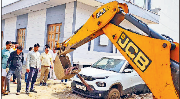
गन्नीर। गली तोड़े जाने के बीचड़ में फंसी गाड़ी को जेसीबी की मदद से निकालते स्थानीय लोग।
