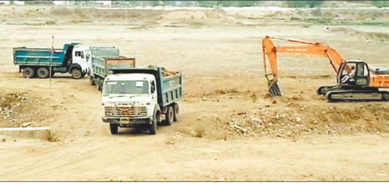
डेढ़ करोड़ रुपए के कांक्रिट कास्टिंग बेकार पड़े: ध्यान रहे कि शनिचरी रफटा की तरफ पूरी तरह से काम बंद है। शनिचरी की तरफ करीब 400 मीटर का टी वाल बना लिया गया था लेकिन अधिकारियों ने काम बंद करा दिया। यहां कांक्रिट कास्टिंग करते हुए सीमेंट के बड़े बाल बनाने में करीब डेढ़ करोड़ खर्च किए गए। यह बेकार पड़े है। यहां सबसे बड़ी समस्या सामान चोरी होने की है। चांटीडीह की तरफ कई बार छड़, सीमेंट और सरिया की चोरी हो जा रही है। इसकी शिकायत भी निगम, प्रशासन और पुलिस से की गई लेकिन कुछ नहीं हुआ। रात में पूरा परिया नशेडियों का अड्डा बन जाता है।
