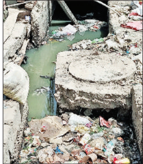
रेवाड़ी। नेहरु पार्क में लंबे समय से ओवरफ्लो हो रहा सीवर, मॉडल टाउन में गंदगी से लबालब नाला तथा सरकुलर रोड पर गंदगी से भरा नाला।
