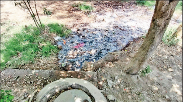
रेवाड़ी। नेहरु पार्क में लंबे समय से ओवरफ्लो हो रहा सीवर, मॉडल टाउन में गंदगी से लबालब नाला तथा सरकुलर रोड पर गंदगी से भरा नाला।
