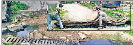
रेवाड़ी। गांव खरखड़ा में जर्जर नाली व टूटी जाली तथा इनसेट में शिकायत के बाद नाली पर नई जाली लगाते कर्मचारी।
