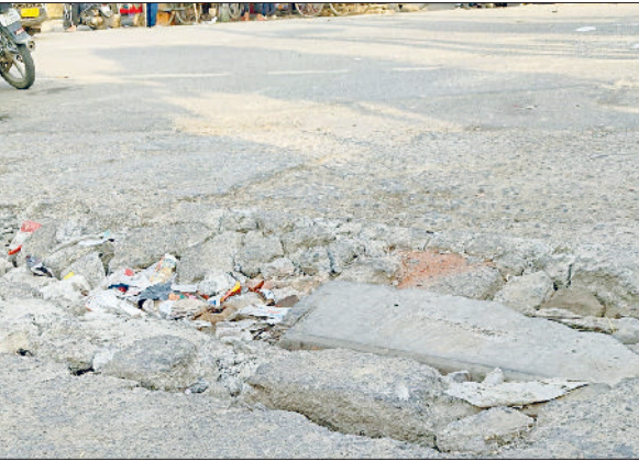
गन्नौर। देवीलाल चौक के पास क्षतिग्रस्त अवस्था में पड़ा नाले का स्लैब।
